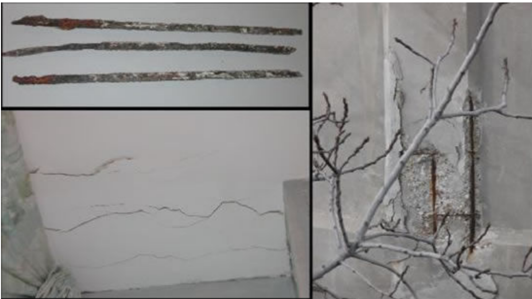
Figura 6. Degrado delle barre: espulsione del copriferro e corrosione dovute ad attacco di cloruri e a carbonatazione del calcestruzzo.
