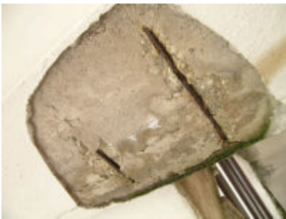
Figura 0. Esempio di degrado nel calcestruzzo armato.
